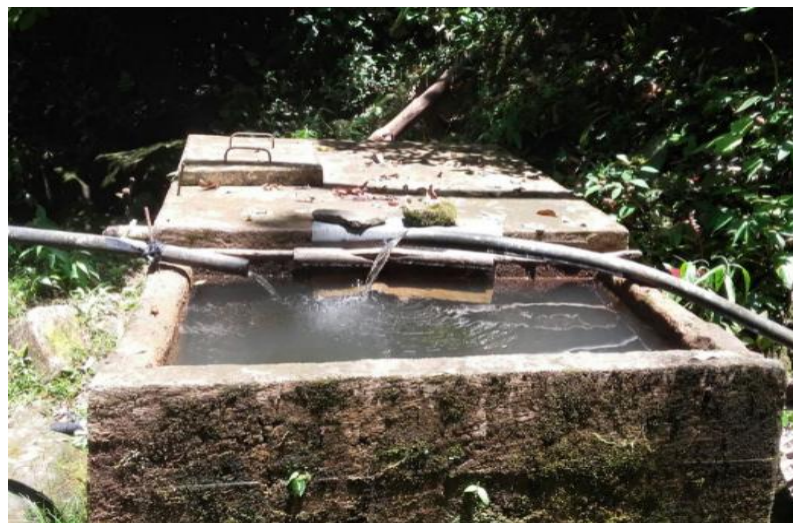
Figura 41. Tanque de almacenamiento
