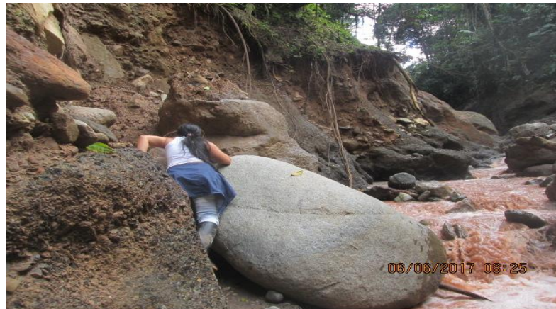
Figura 17. Erosión de las márgenes del río
