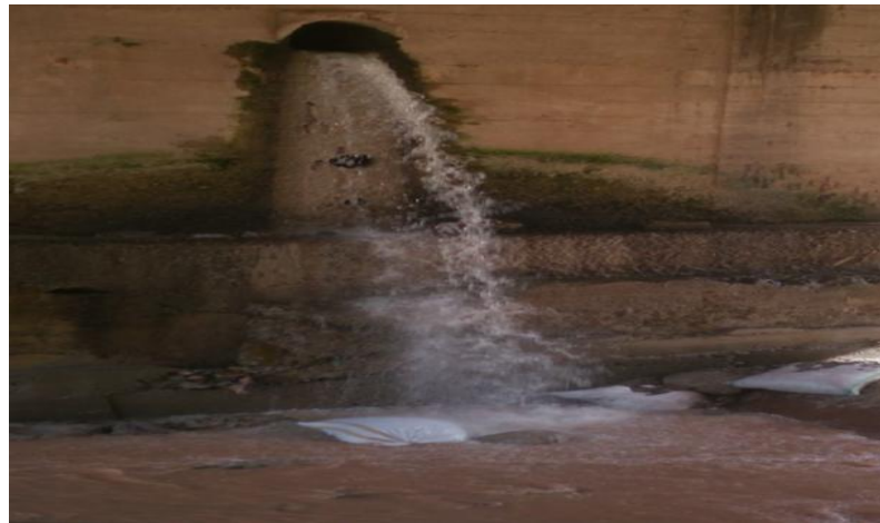
Figura 51. Punto de Vertimiento. Puente Av. Colombia – Centro Después de la avenida torrencial.
