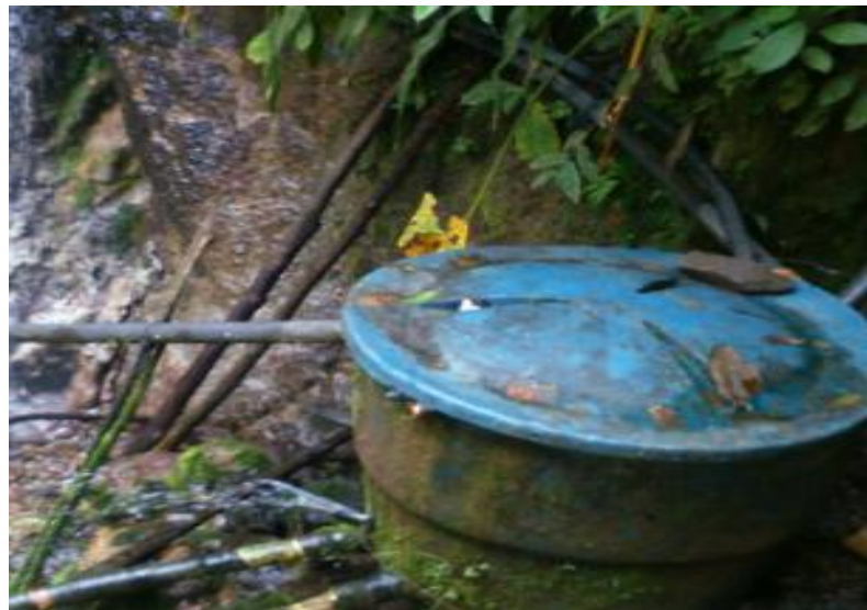
Figura 40. Tanque de captación.
