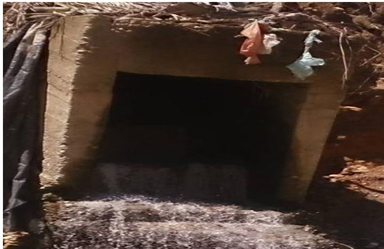
Figura 48. Colector box culvert barrio Los Prados después de la avenida torrencial súbita.
