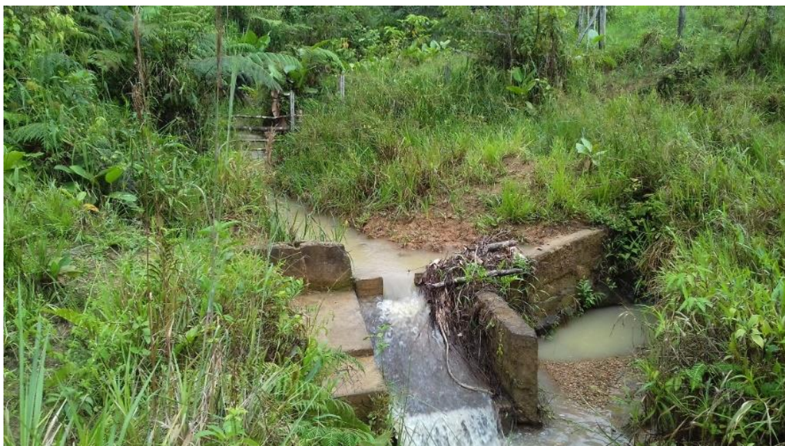
Figura 2. Captación en la quebrada La Escalera. Fuente: Este trabajo
