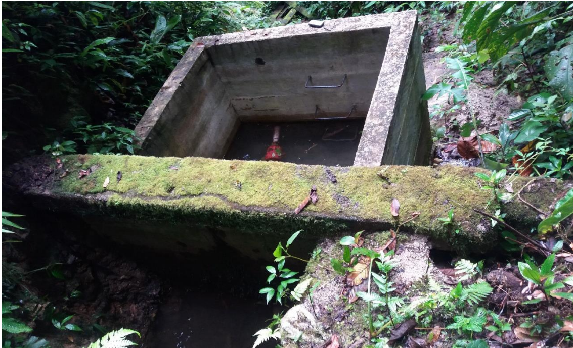
Figura 4. Bocatoma del sistema de acueducto de San Antonio. Fuente: este trabajo
