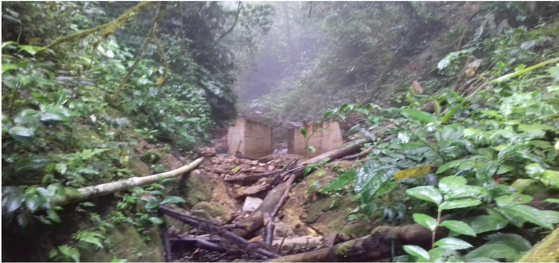
Figura 5. Bocatoma del sistema de acueducto de Campucana. Fuente: este trabajo
