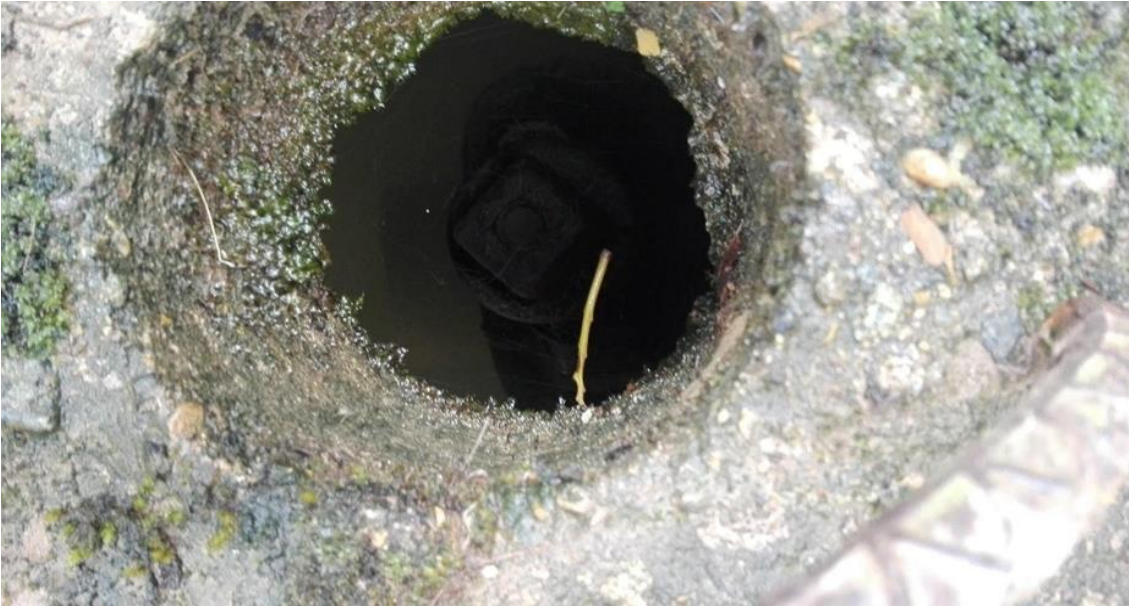
Figura 4.Válvula de corte acueducto Alto Eslabón
