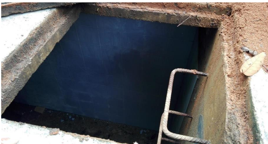
Figura 8. Tanque que se encuentra sin terminar acueducto Alto Eslabón.
