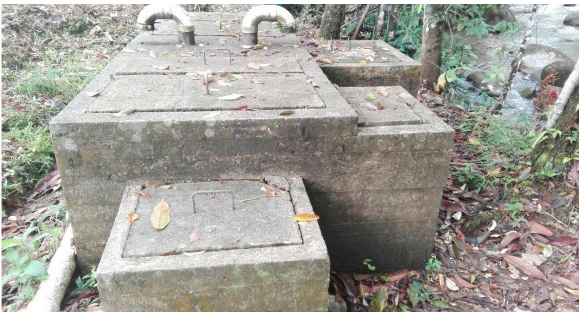
Figura 5.Desarenado de flujo ascendente acueducto Alto Eslabón.
