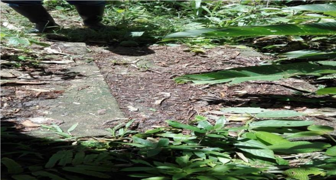
Figura 15.Desarenador flujo Ascendente acueducto Villa Gloria de Toroyaco.
