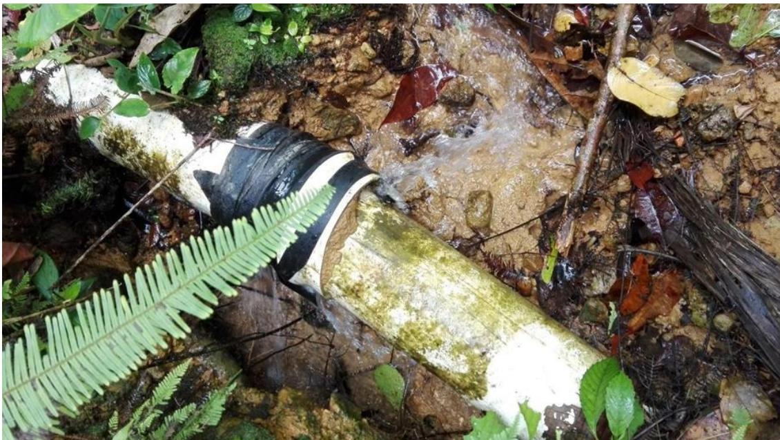
Figura 14. Tubería Aducción acueducto Villa Gloria de Toroyaco.
