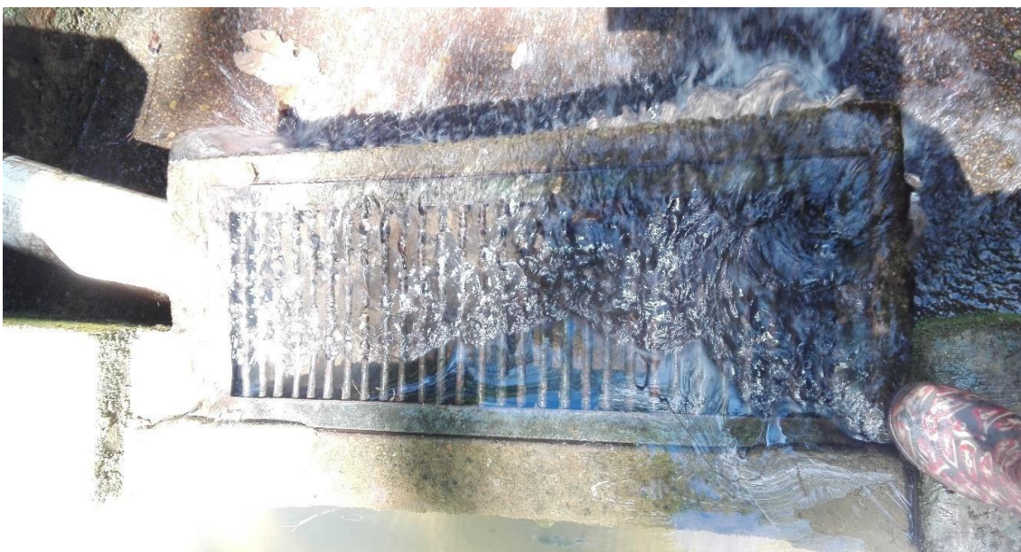
Figura 11. Rejillas acueducto Villa Gloria de Toroyaco.
