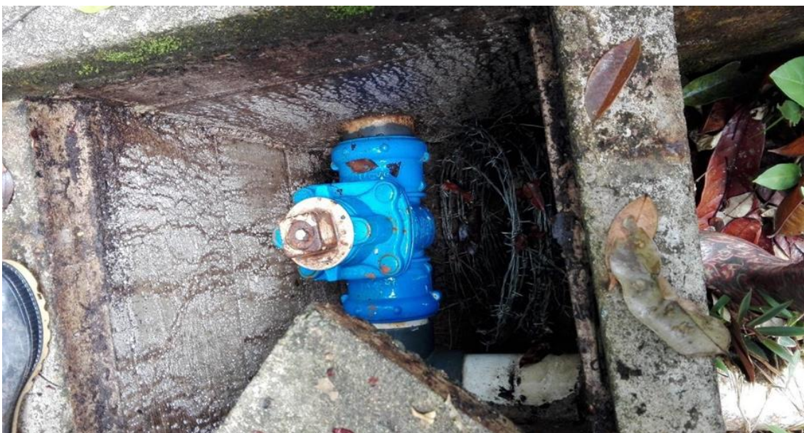
Figura 6. Válvula del desarenador acueducto Alto Eslabón.
