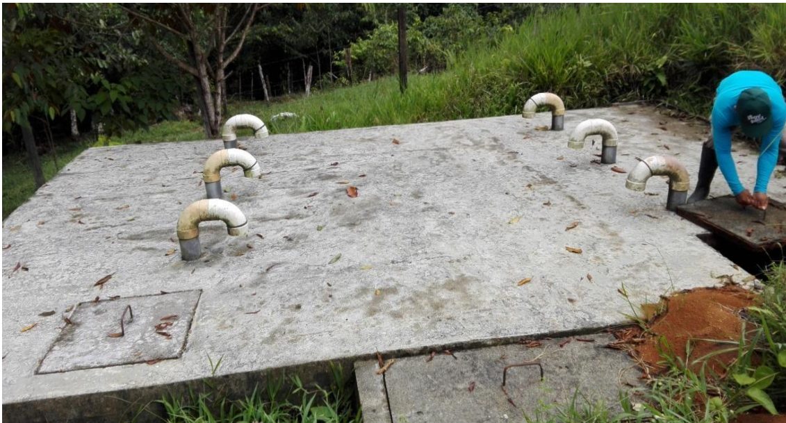
Figura 7. Tanques de almacenamiento doble compartimiento acueducto Alto Eslabón.
